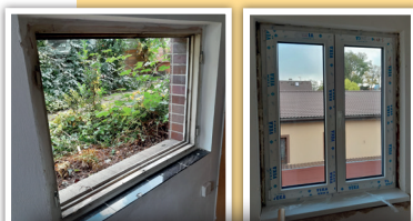
Původní okenní rámy (vlevo) už byly nevhovující. Vpravo nové okno
